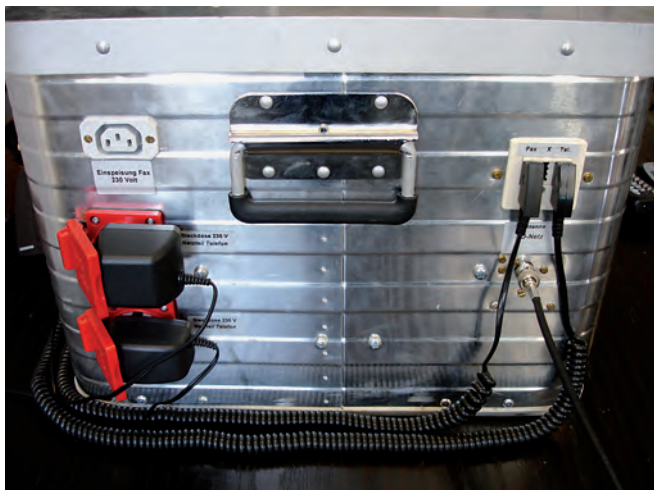
Anschlüsse zur Versorgung der Endgeräte sowie Antennenanschluss.
